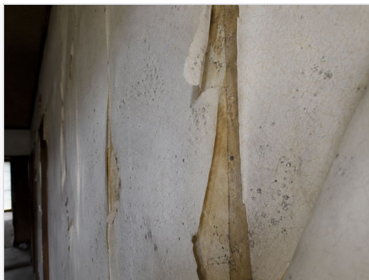
廊下壁面 クロスの剥がれ・汚れ・カビの状態
