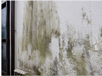
外壁劣化 苔・汚れ・ひび割れ等 の状態
