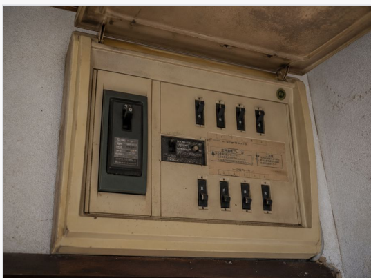
電気設備 ブレーカー・メーターの状態
