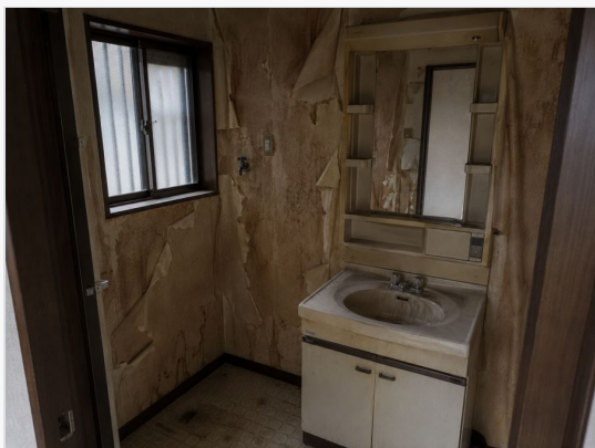
洗面室 洗面台・壁のカビ・劣化の状態
