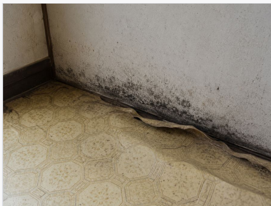
台所劣化 壁・床のカビ・腐食の状態
